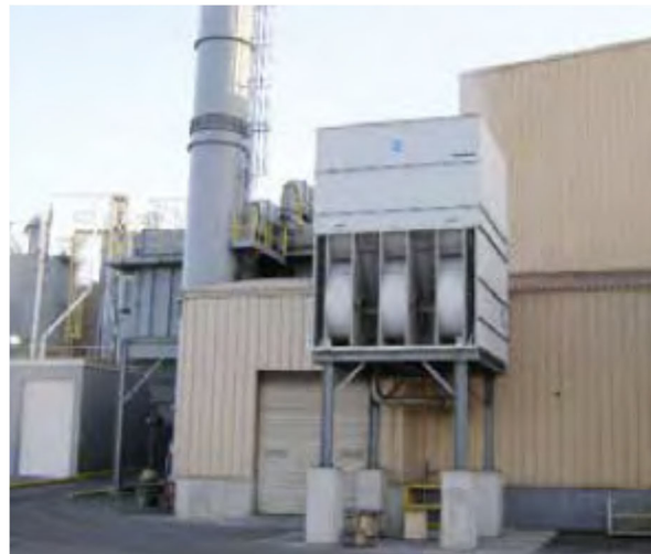
Plant 1 に導入したクローズドループ水冷システム
